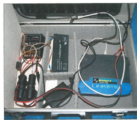
Bild 2: Die Stromversorgung und der Access-Point des APRS-Empfängers liegen im Koffer unter der Abdeckung.
